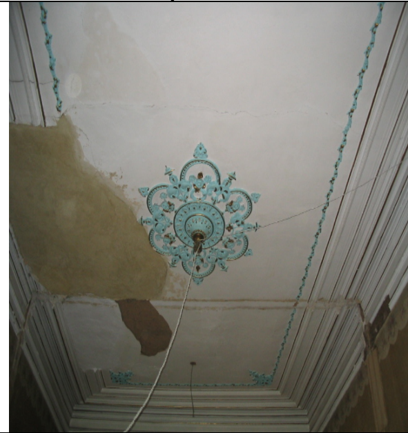
Daños en el cieloraso
