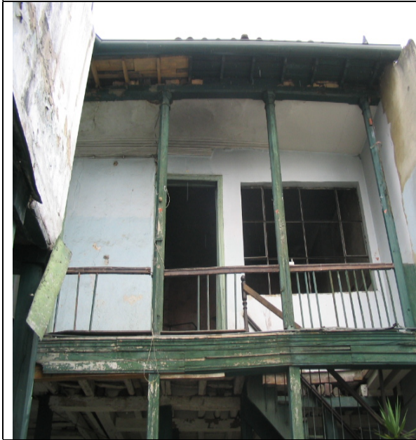
Deterioro del interior
