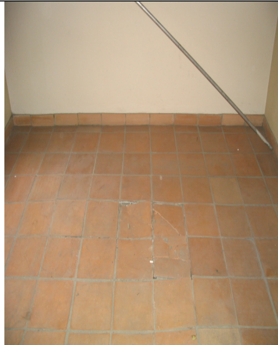
Hundimiento del piso en habitación
