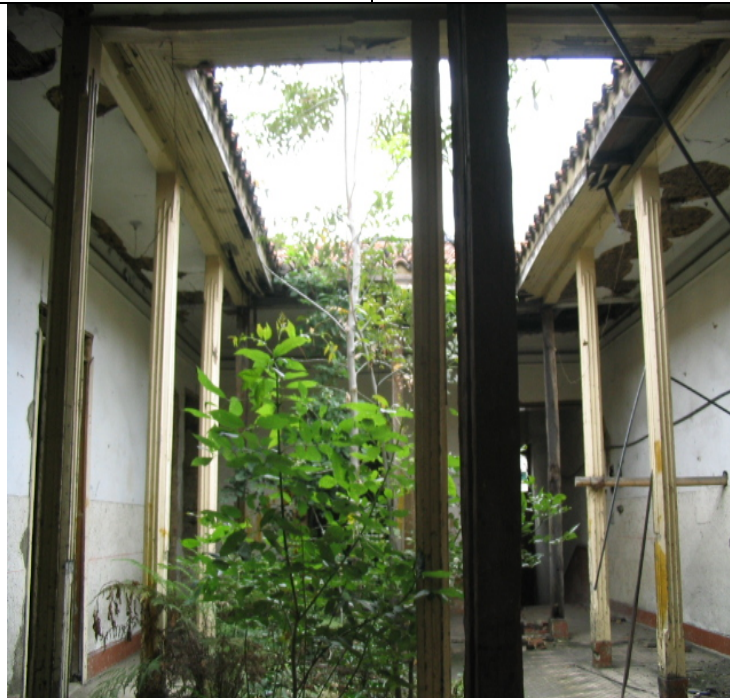
Estado actual de la parte interna del frente de las Casas gemelas a restaurar
